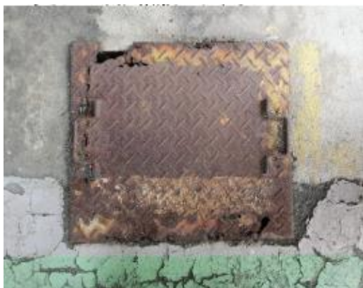
・腐食により穴が開いている
