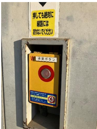
・ホーム非常ボタン
