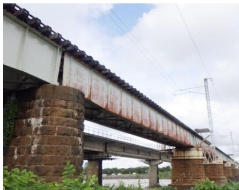
・東滑川～魚津駅間早月川橋梁 経年によるさびが発生
